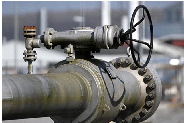
Van điều chỉnh trong hệ thống đường ống dẫn khí đốt OGE ở Werne, miền Tây Đức
