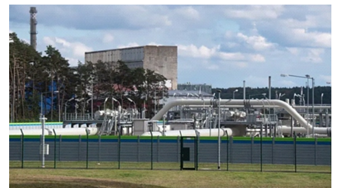
Hệ thống đường ống và thiết bị đóng ngắt tại trạm tiếp nhận khí đốt của đường ống Dòng chảy phương Bắc 2 qua Biển Baltic ở Lubmin, Đức, ngày 26/9/2022
